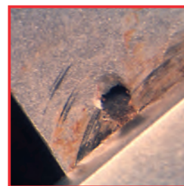
Пример язвенной коррозии
