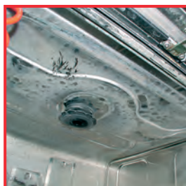
Промывная камера с сильной накипью
